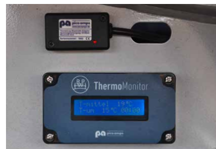
Co minutę, układ kontroli monitoruje temperaturę przewożonego asfaltu.
